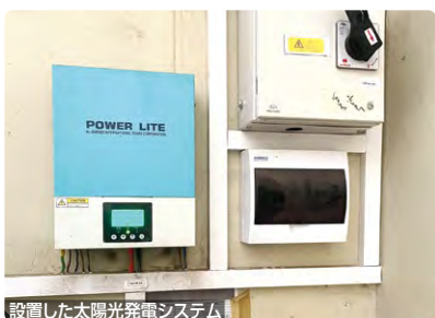
設置した太陽光発電システム
