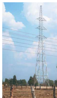
活動村に設置された 水力発電ダムの送電線
